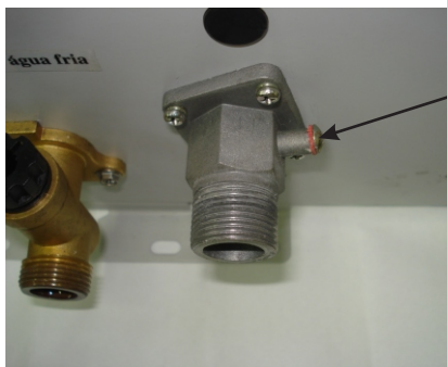
Espera conexão entrada gás -Pressão Primária-
